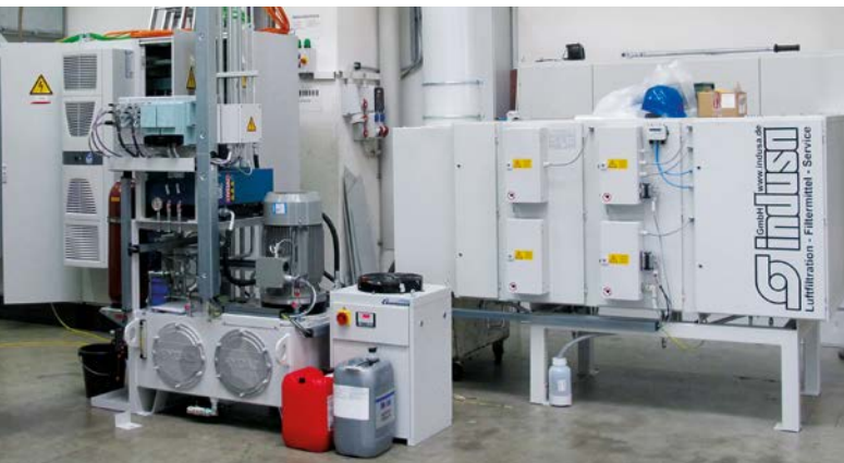
HYDRAULISCHE TRENNVORGÄNGE ZWISCHEN SCHALTSCHRÄNKEN
